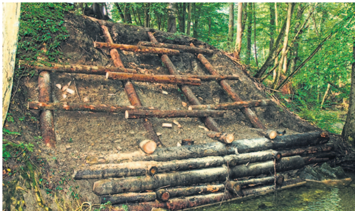
Im Werenbachtobel hat ein Trupp von Zivilschutzpionieren eine Hangverbauung erstellt. Diese Hangsicherung baut auf dem Ergebnis eines Zivilschutzeinsatzes im Vorjahr auf, als das unterspülte Ufer mit einem Hangkasten gesichert wurde. (Bilder: Thomas Stettler)
